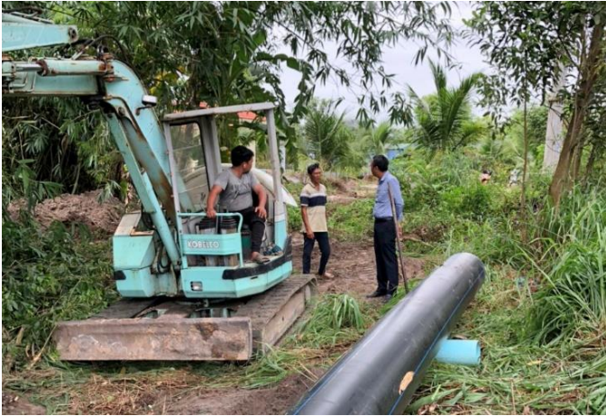
Ông Đoàn Hữu Ngọc Thường (bìa phải) - Giám đốc Chi nhánh Cấp nước Chơn Thành kiểm tra công tác thi công
